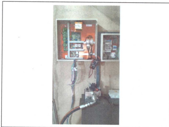
Casa de máquina do elevador
