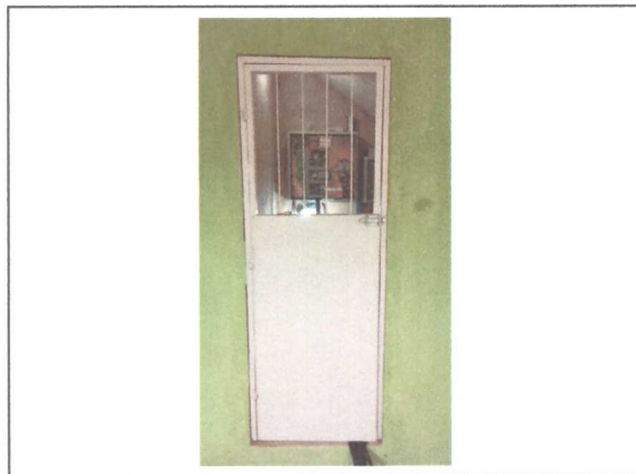
Portão da casa de máquina do elevador
